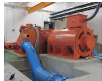
浄水場内の小水力発電機
