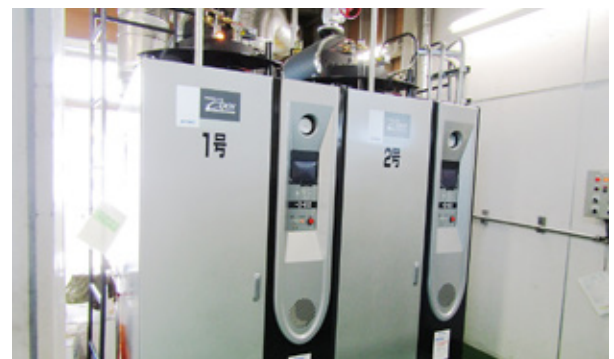
団地工場に新たに導入したボイラ
